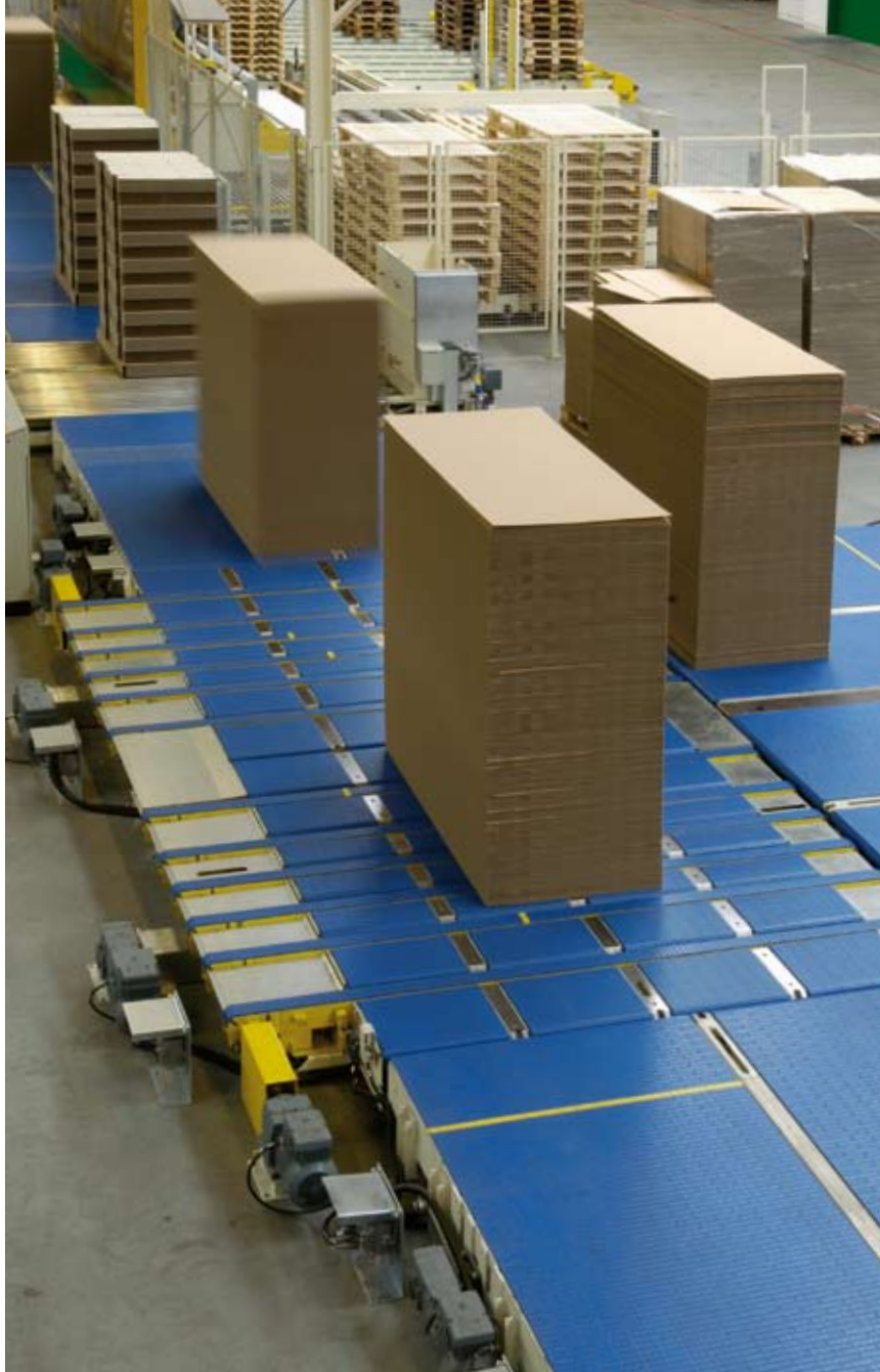
Rollenbahnen und besonders die Scherstellen mit Transferwagen sind eine nicht zu unterschätzende Gefahrenquelle, die besonders gesichert werden muss.
